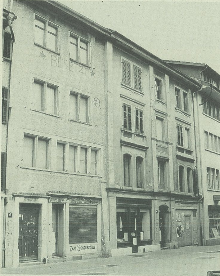
Ins Tösserhaus und den Blumengarten kommt das neue Gewerbe- und Uhrenmuseum. Die beiden Häuser sind in sehr schlechtem baulichen Zustand und müssen dringend saniert werden.
